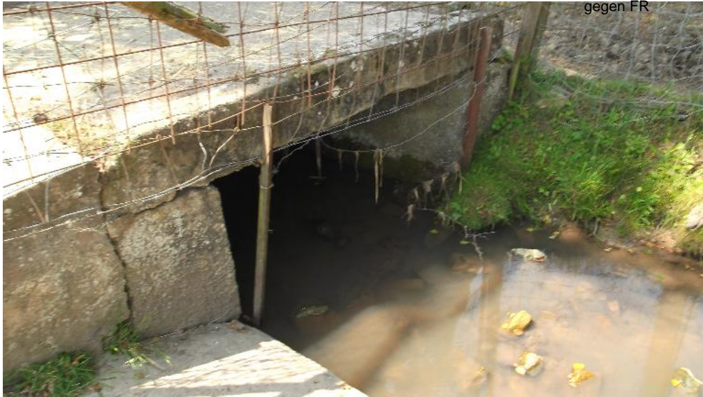
Durchlass; Lauf verengt
