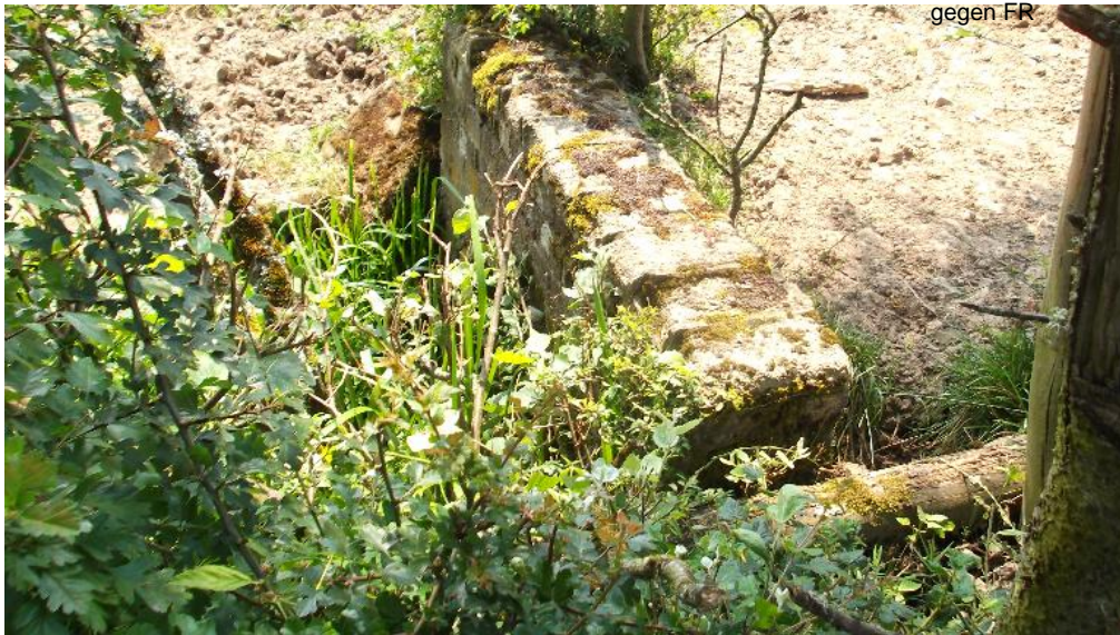
Durchlass; Lauf verengt
