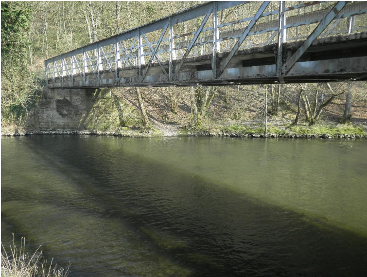
Durchlass; Ufer unterbrochen
