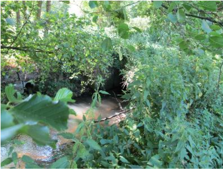
Durchlass; Ufer unterbrochen
