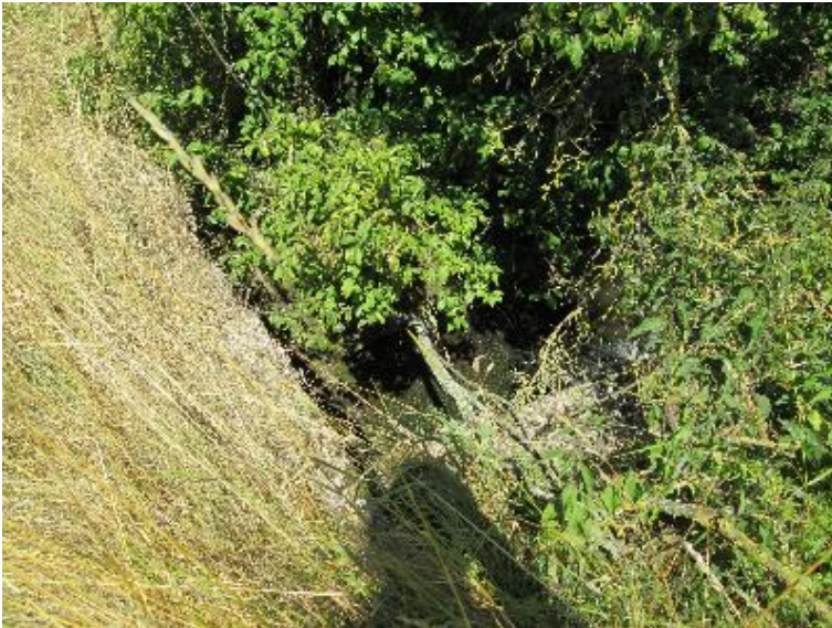
Absturz aus Verrohrung
