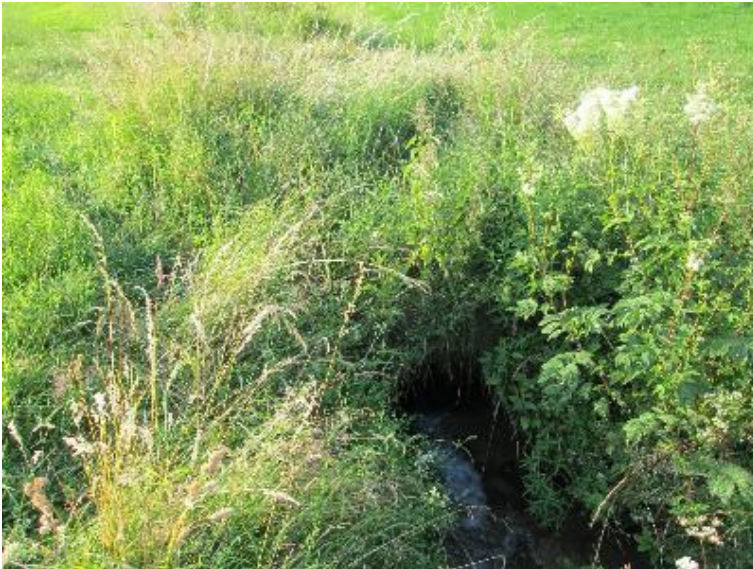
Absturz aus Verrohrung
