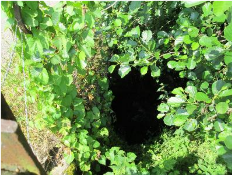
Absturz aus Verrohrung
