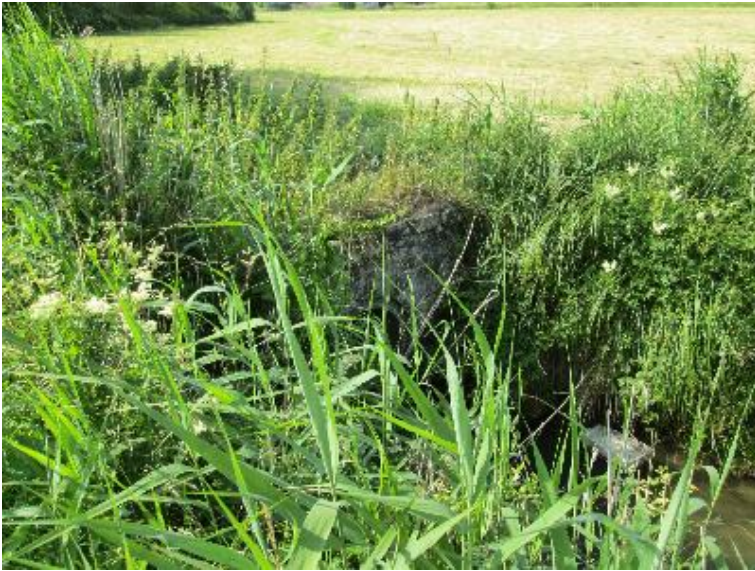
Absturz aus Verrohrung
