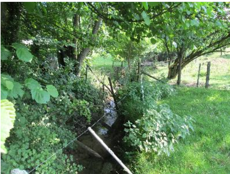
Durchlass; Ufer unterbrochen
