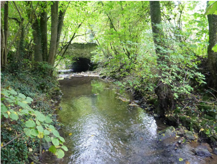
Durchlass; Lauf verengt
