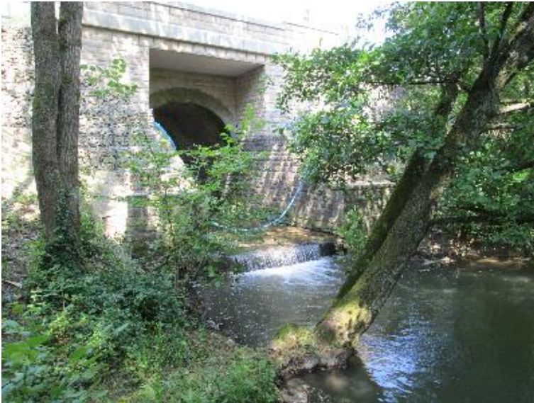
Absturz aus Verrohrung
