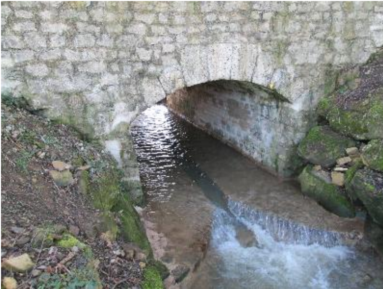
Absturz aus Verrohrung
