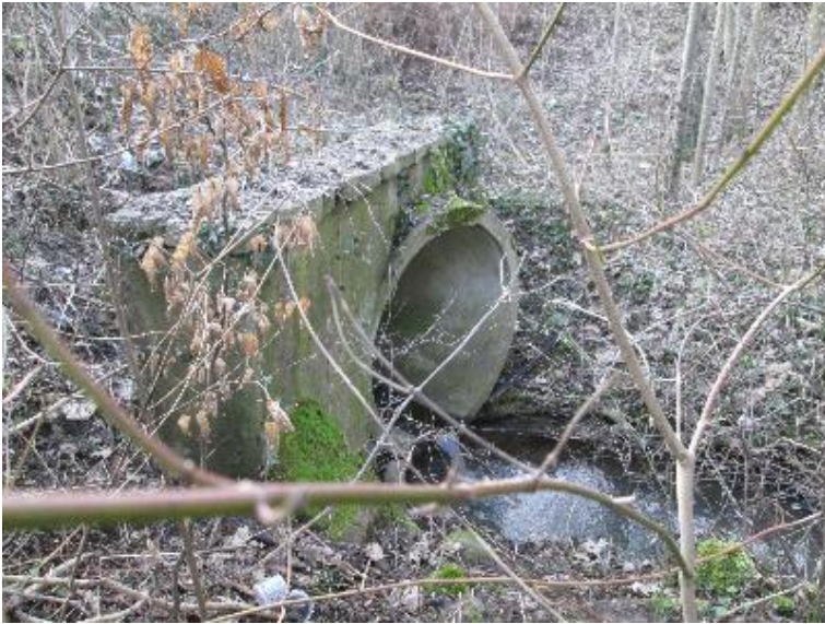
Absturz aus Verrohrung
