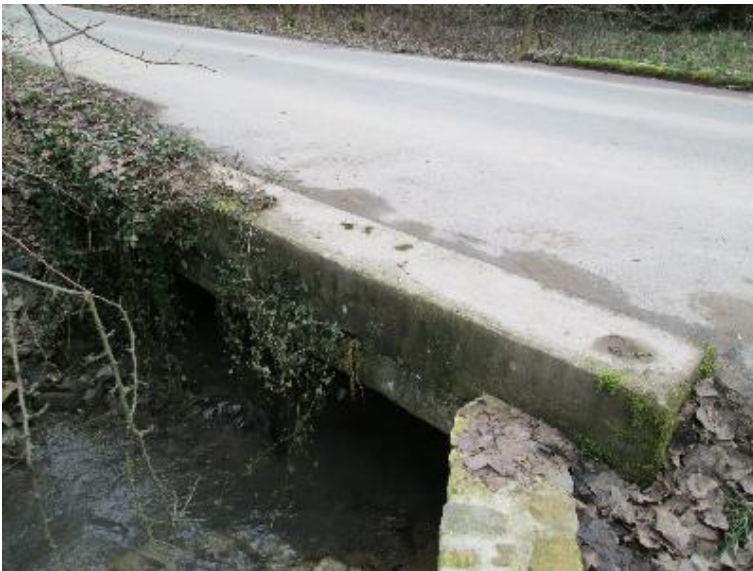
Durchlass; Ufer unterbrochen
