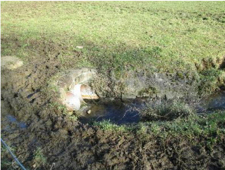
verrohrt bzw. ueberdeckt - Absturz aus Verrohrung
