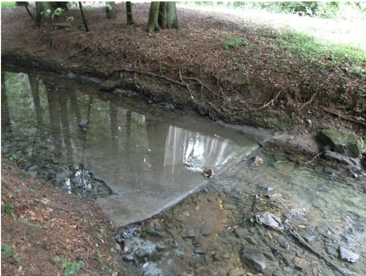
Absturz; kleiner - Sohlenverbau
