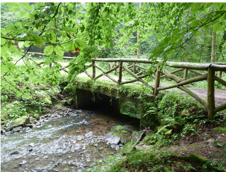
Durchlass; Lauf verengt
