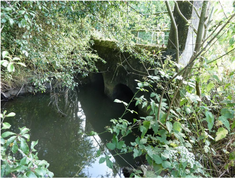
Durchlass; Lauf verengt
