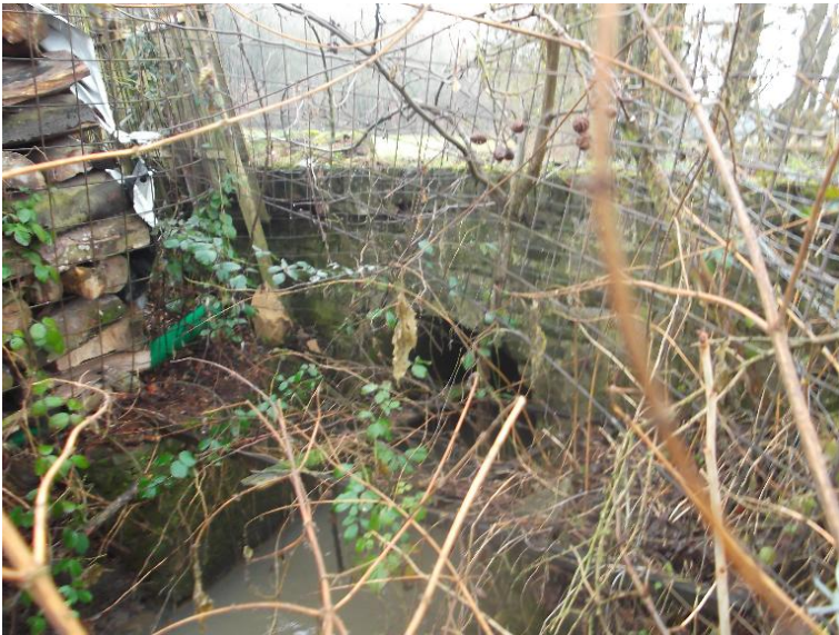
Durchlass; Lauf verengt
