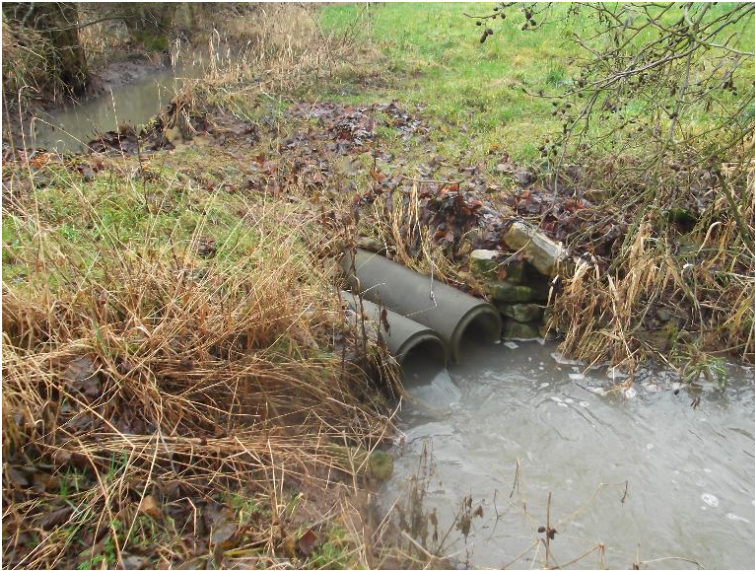
Durchlass; Lauf verengt
