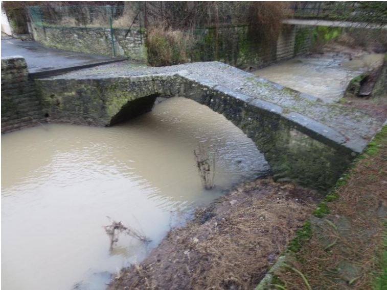
Durchlass; Lauf verengt
