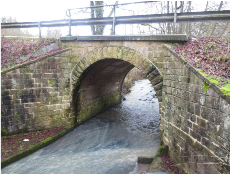
Durchlass; Ufer unterbrochen
