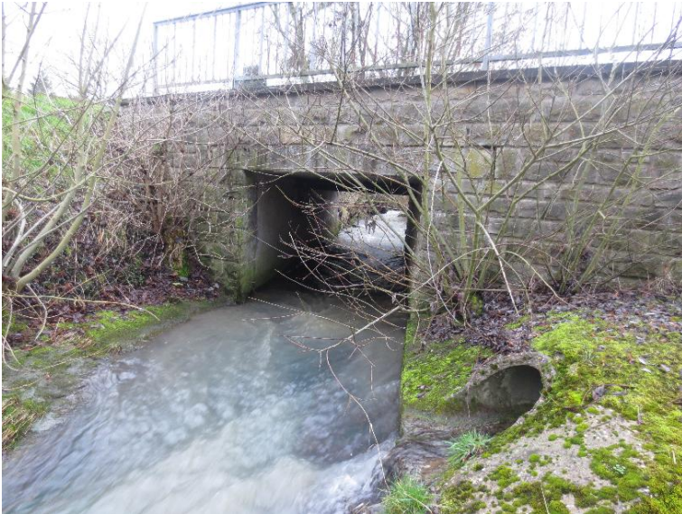
Durchlass; Ufer unterbrochen
