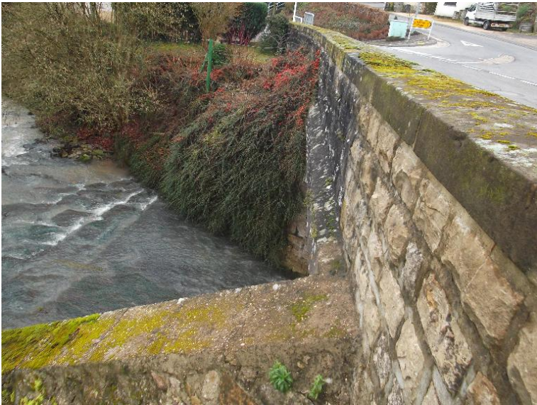
Durchlass; Lauf verengt
