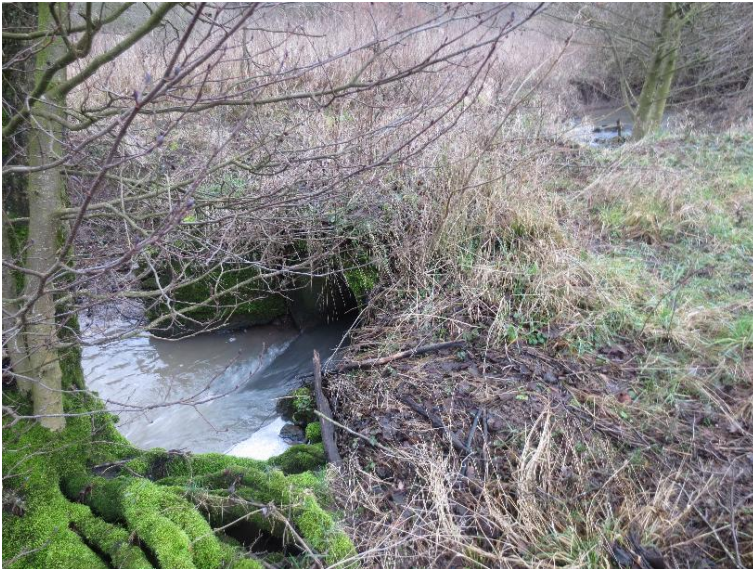
Durchlass; Lauf verengt
