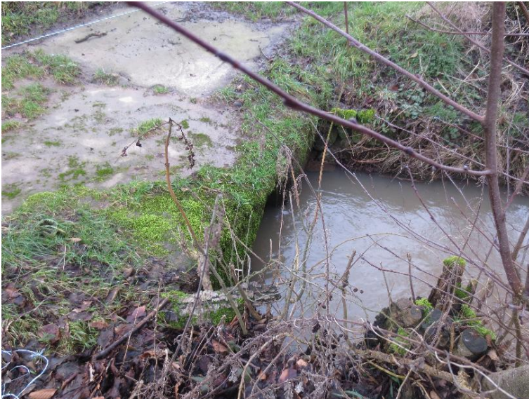
Durchlass; Lauf verengt
