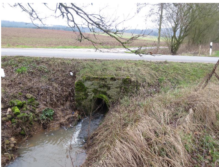
Durchlass; Lauf verengt
