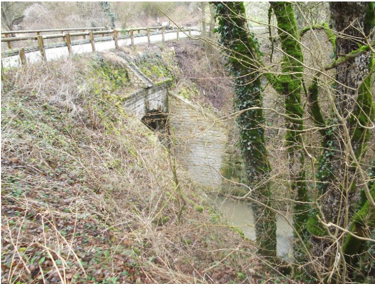
Durchlass; Lauf verengt
