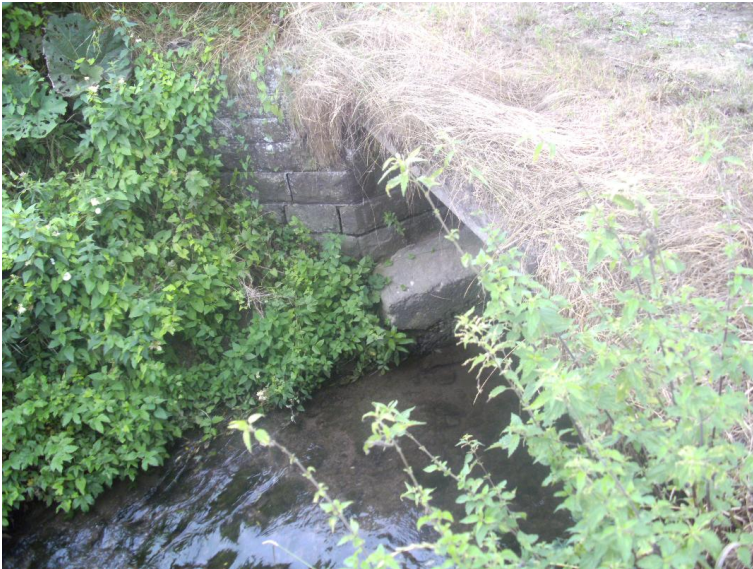
Durchlass; Ufer unterbrochen
