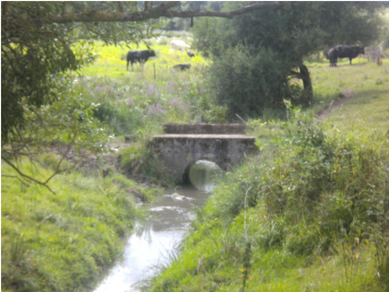
Durchlass; Lauf verengt
