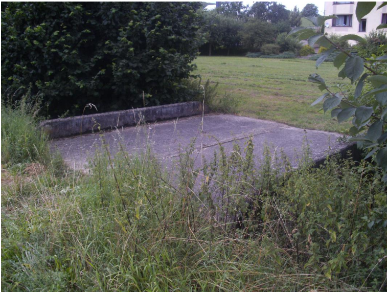
Durchlass; Ufer unterbrochen
