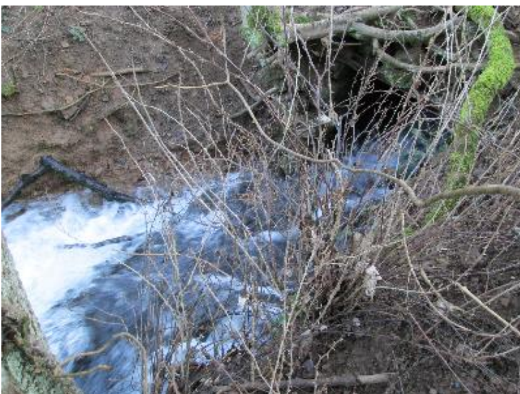
Absturz aus Verrohrung
