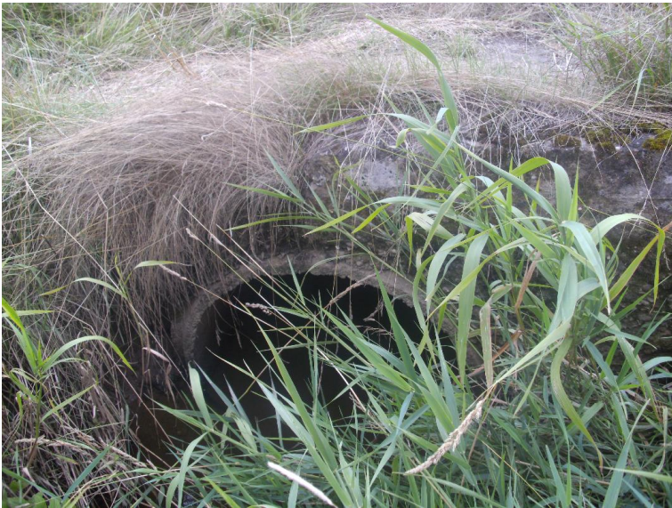
Durchlass; Lauf verengt
