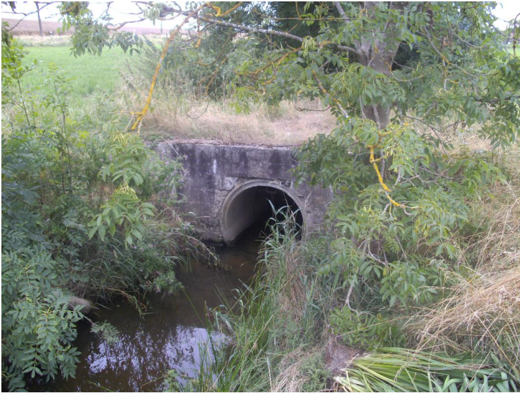
Durchlass; Lauf verengt
