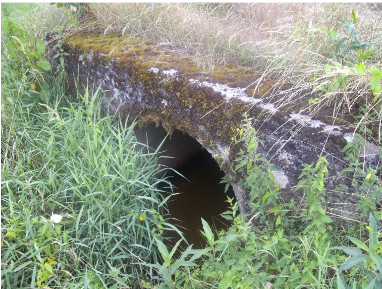
Durchlass; Ufer unterbrochen
