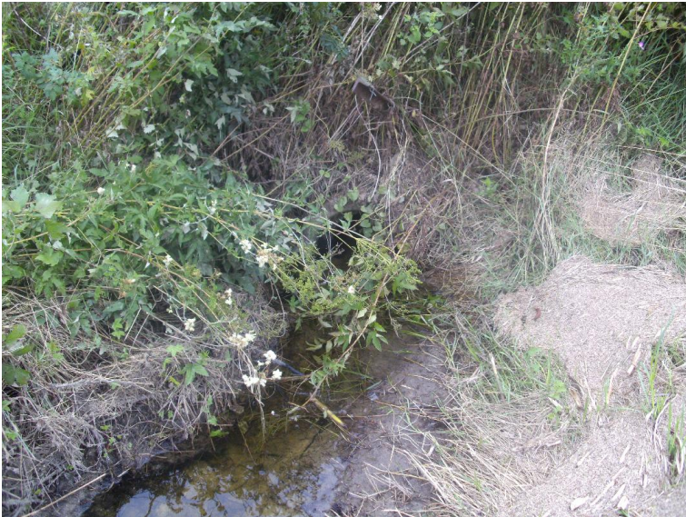
Durchlass; Ufer unterbrochen
