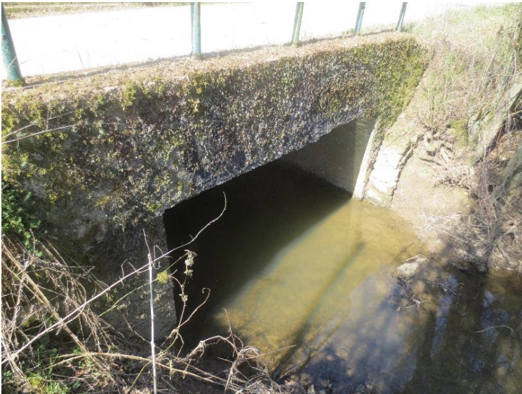
Durchlass; Ufer unterbrochen
