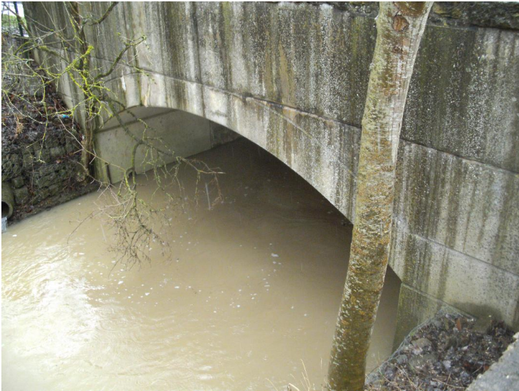
Durchlass; Ufer unterbrochen
