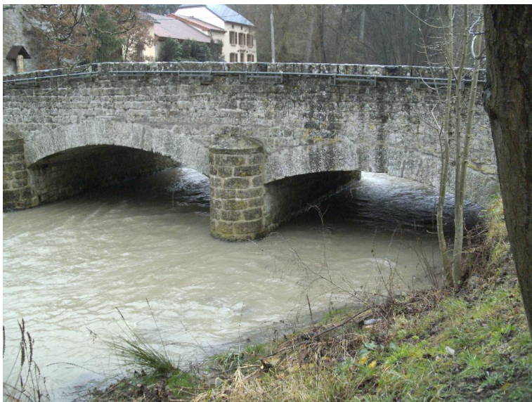
Durchlass; Ufer unterbrochen
