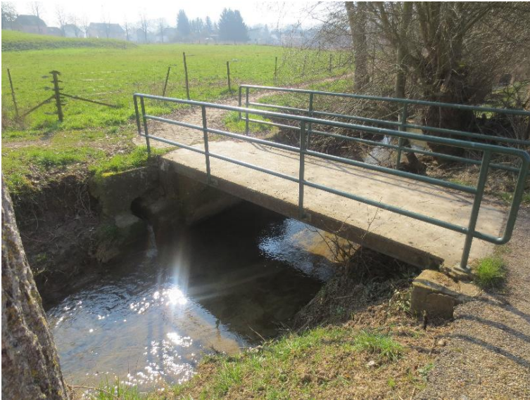
Durchlass; Ufer unterbrochen
