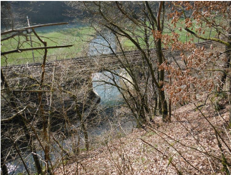
Durchlass; Lauf verengt
