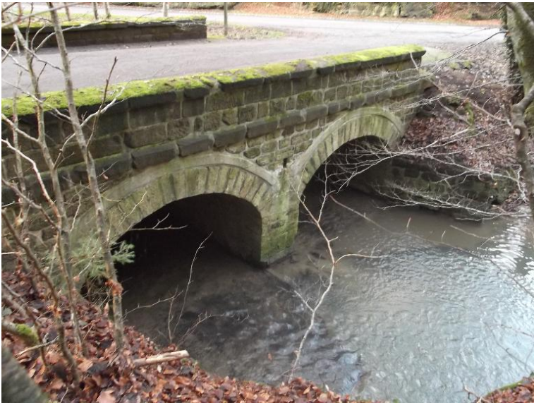
Durchlass; Lauf verengt
