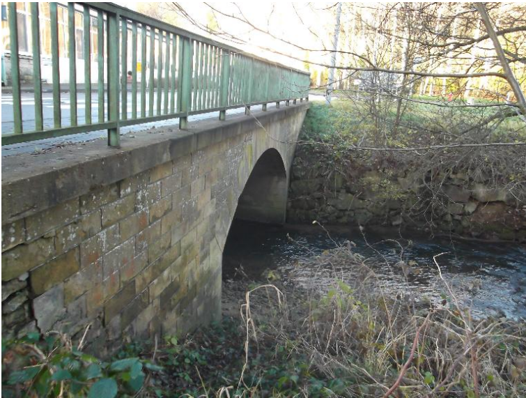
Durchlass; Lauf verengt
