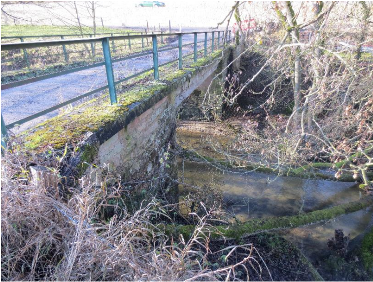
Durchlass; Ufer unterbrochen
