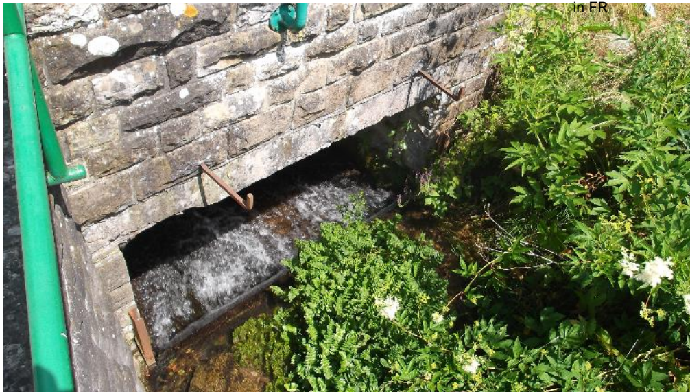
Durchlass; Lauf verengt
