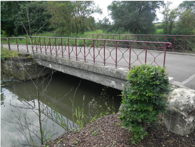
Durchlass; Ufer unterbrochen
