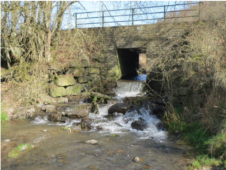
Absturz; hoher - Durchlass; Lauf verengt
