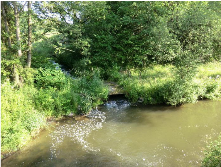
Durchlass; Lauf verengt
