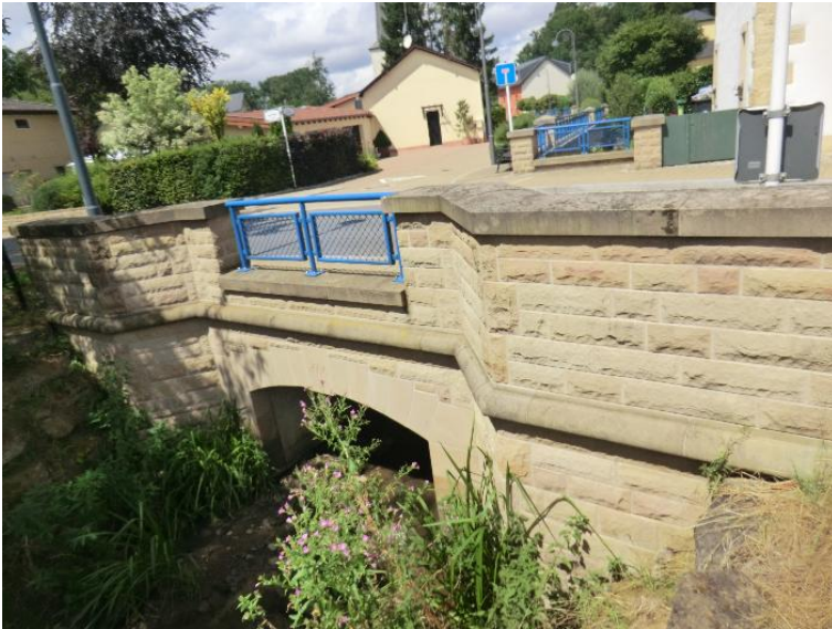
Durchlass; Ufer unterbrochen
