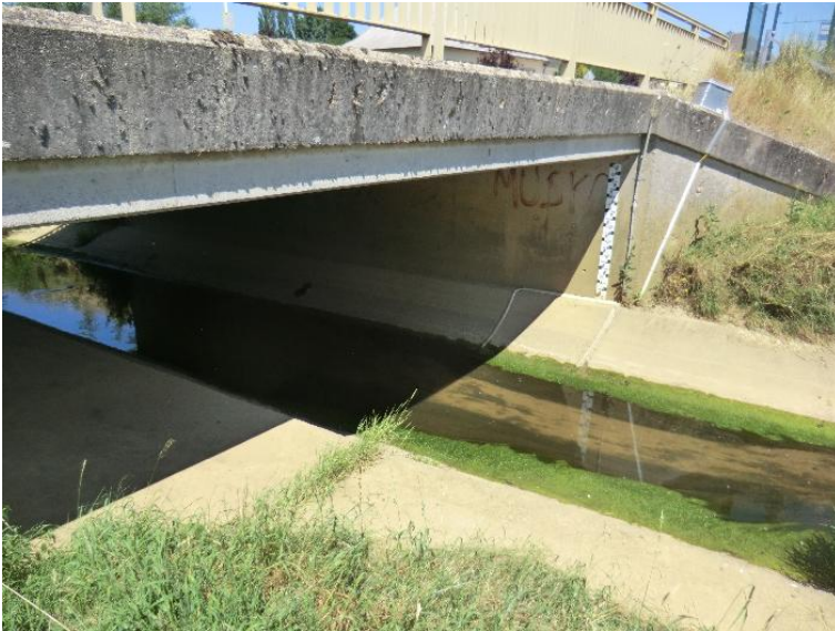
Durchlass; Ufer unterbrochen
