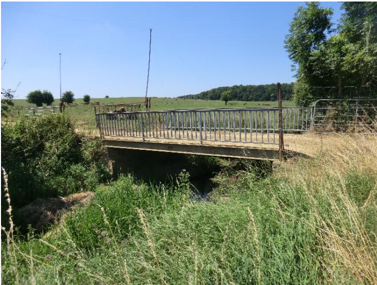
Durchlass; Ufer unterbrochen
